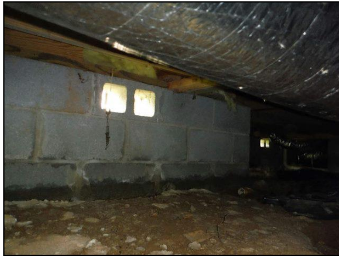
No vapor barrier
